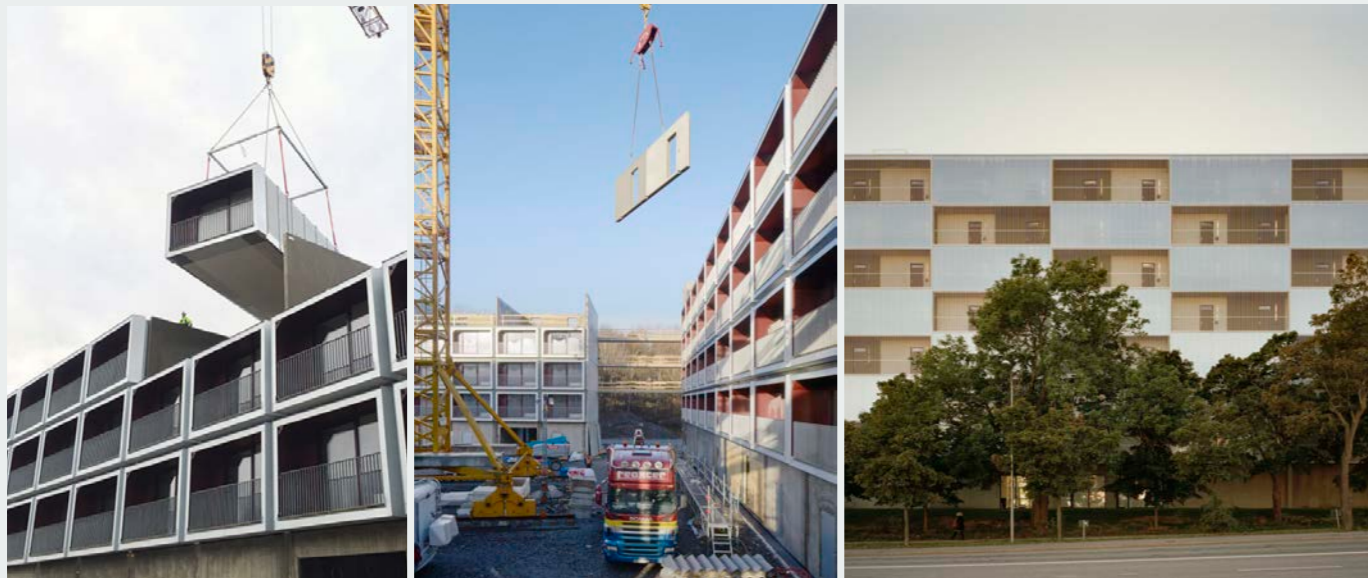
▲ 7.07 Snabba Hus Västberga, Stockholm, Sweden - Architect: Andreas Martin-Löf Arkitekt, Developer: New Living
